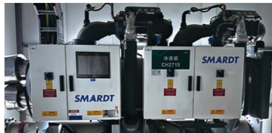
益海（广汉）粮油饲料有限公司 磁悬浮冷水机组
